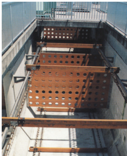
▼ 汚泥かき寄せ機フライト
